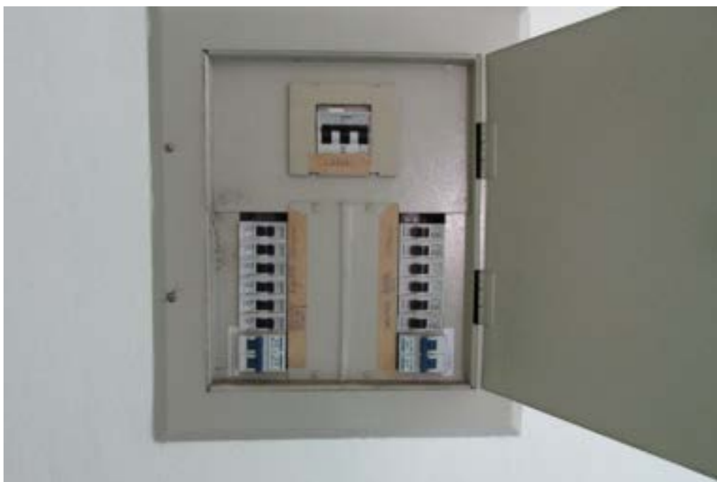
8- Quadro de energia
