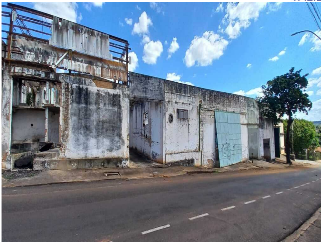
Fotografia 15 – Aspecto do imóvel avaliado e das construções existentes em estado de ruína.
