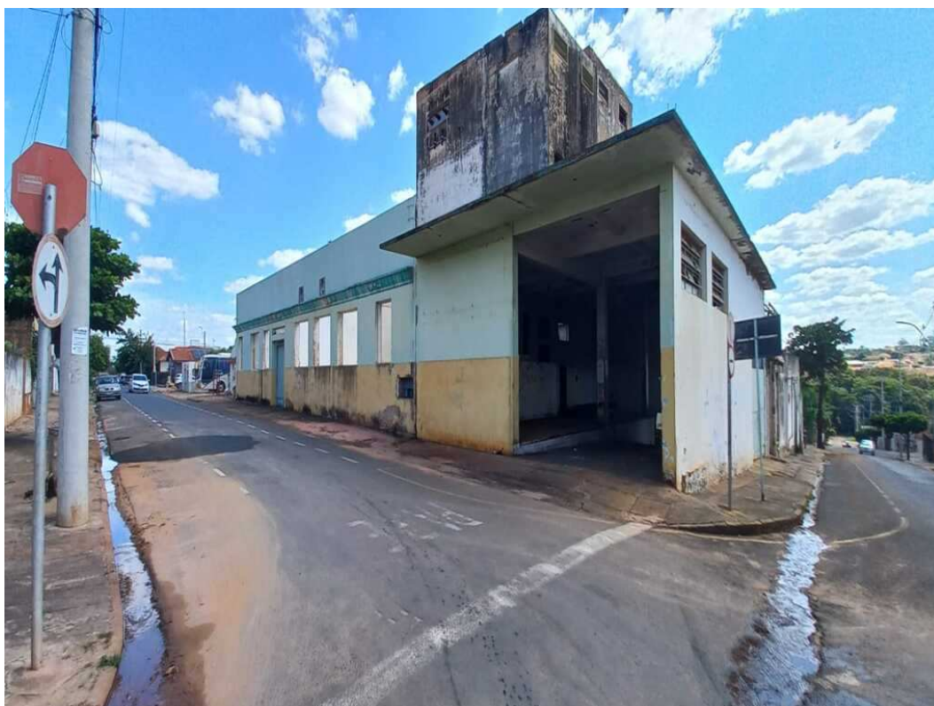
Fotografia 12 – Aspecto do imóvel avaliado e das construções existentes em estado de ruína.
