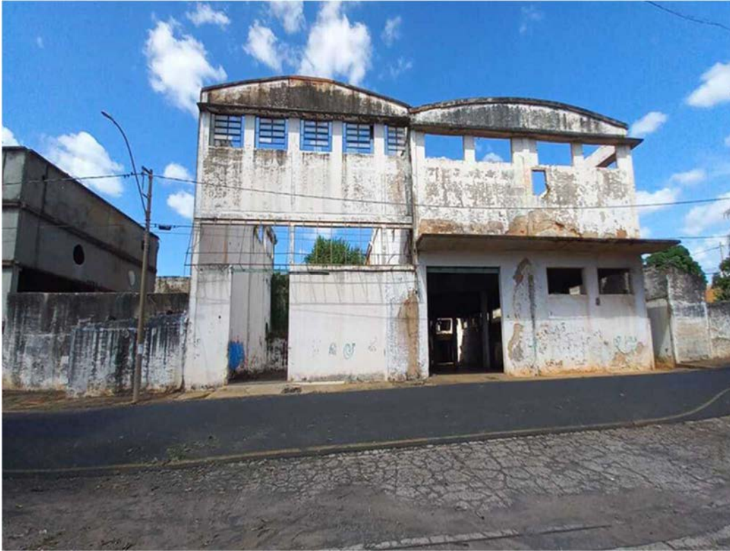
Fotografia 13 – Aspecto do imóvel avaliado e das construções existentes em estado de ruína.
