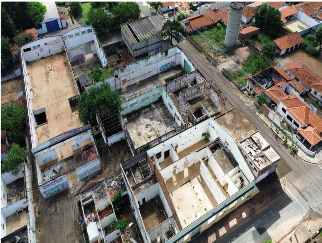
Fotografia 08 – Aspecto do imóvel avaliado e das construções existentes em estado de ruína.
