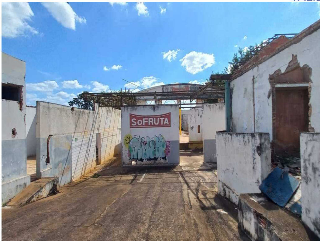
Fotografia 11 – Aspecto do imóvel avaliado e das construções existentes em estado de ruína.
