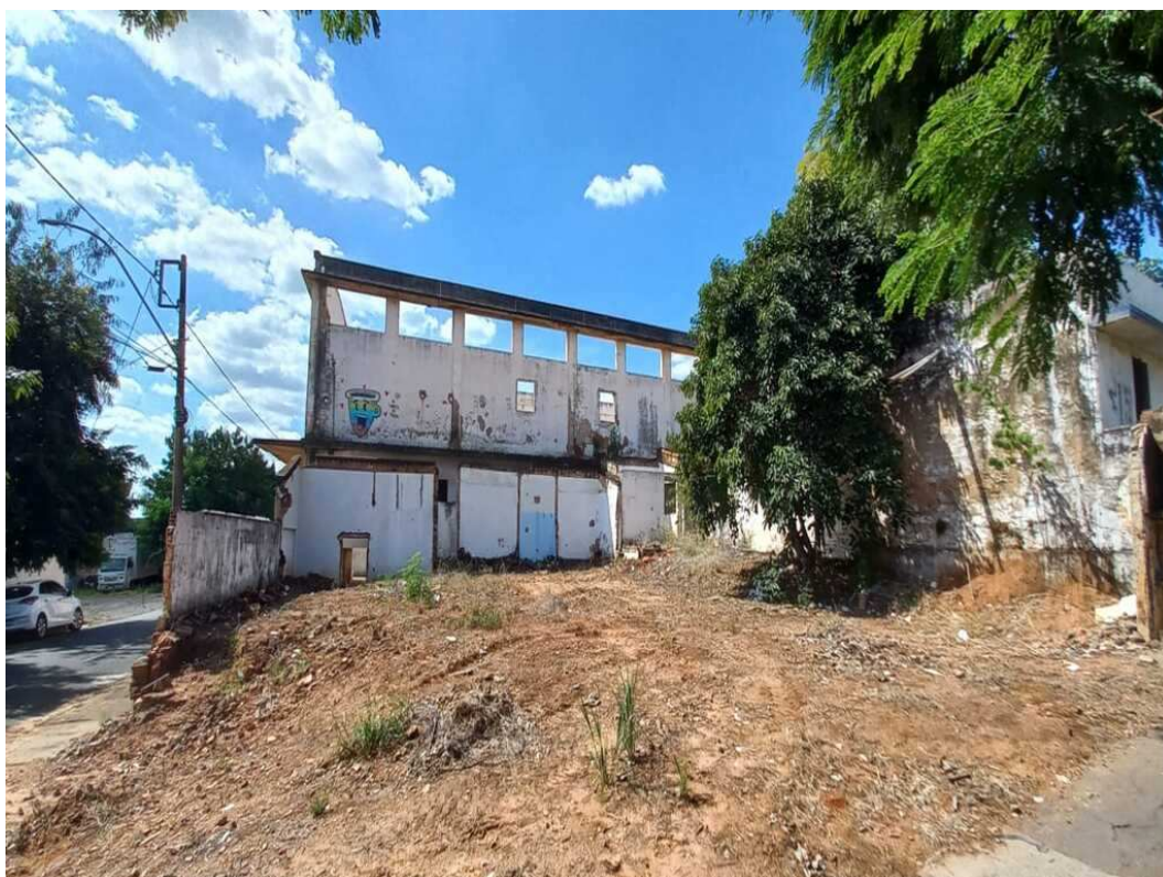
Fotografia 18 – Aspecto do imóvel avaliado e das construções existentes em estado de ruína.
