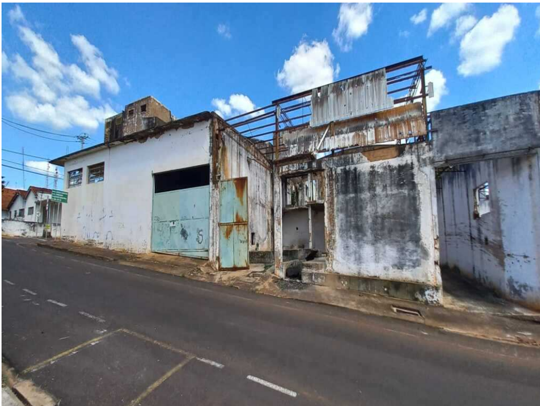
Fotografia 14 – Aspecto do imóvel avaliado e das construções existentes em estado de ruína.
