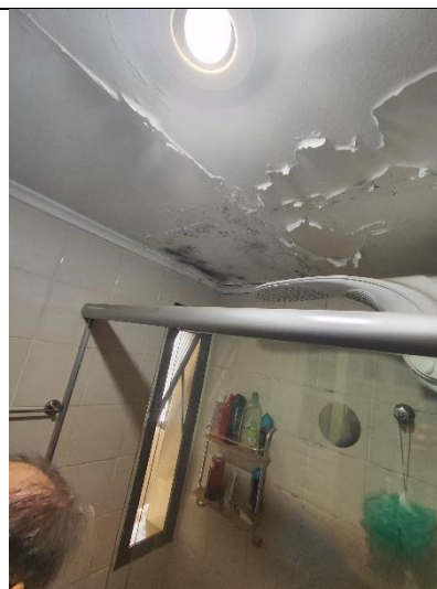
Foto 34 – Teto manchado e pintura descascando.
