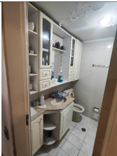
Foto 31 – Idem, armários e gabinetes, piso cerâmico, AZT padrão, teto descascando.
