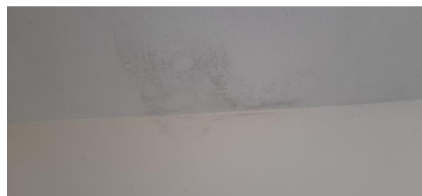
SINAL DE UMINADE – LAJE DORMITÓRIO
