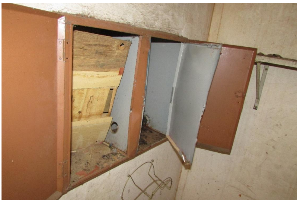
6- Caixas de força desativadas
