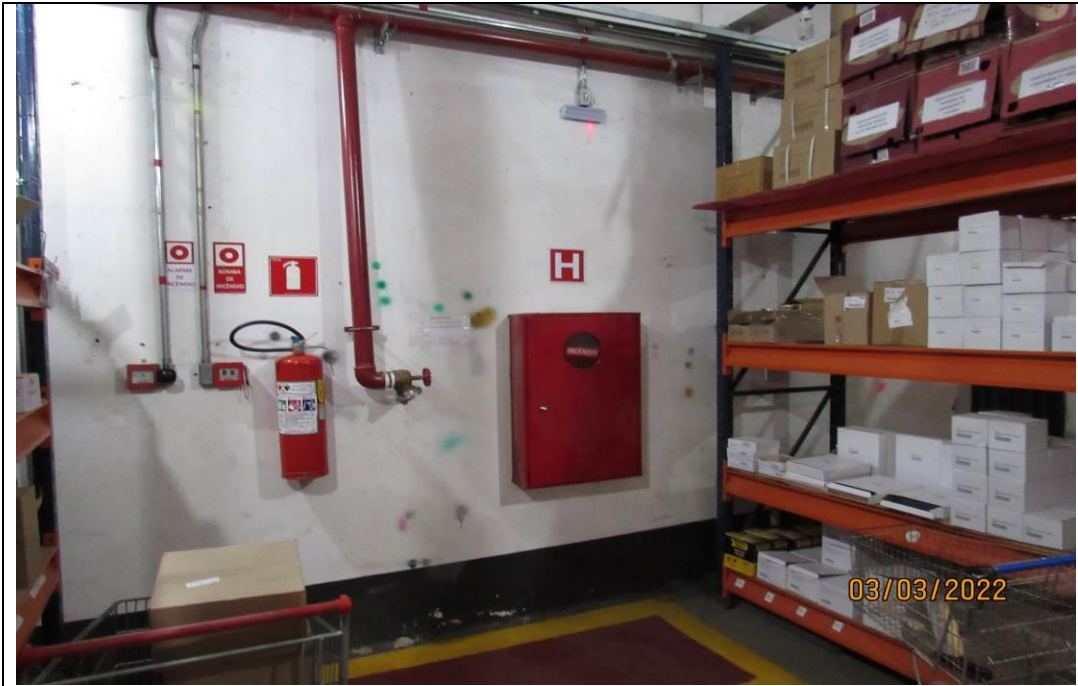
FOTO 10 – Vista geral de parede com itens de brigada de incêndio do imóvel.
