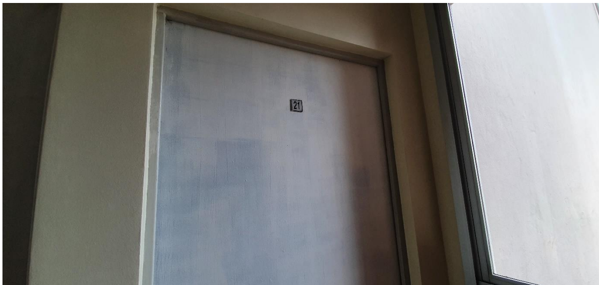
Figura 7: Porta de entrada na unidade avaliando nº 21 do bloco 02
