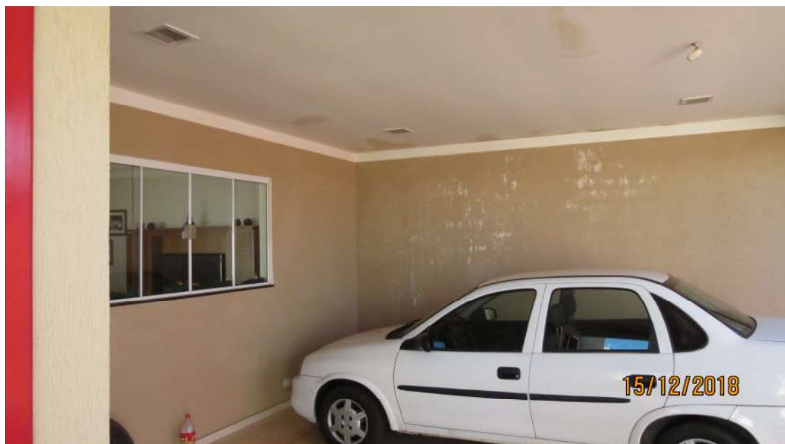
Figura 7 – Garagem. No forro de gesso, observa-se manchas de infiltração de umidade.
