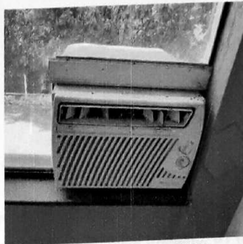
49- AR CONDICIONADO DE JANELA
