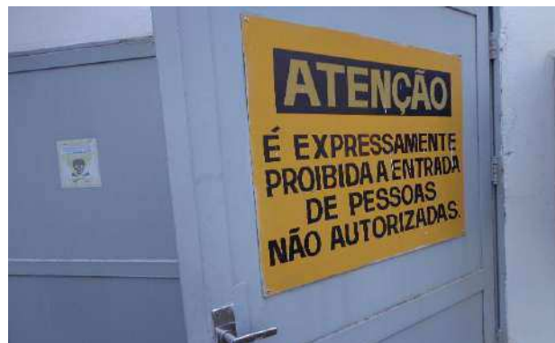
FOTO 111 cabine de força.
