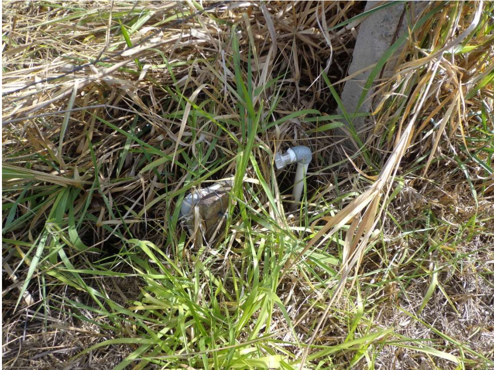
6- Rede de alimentação de água potável desativada.
