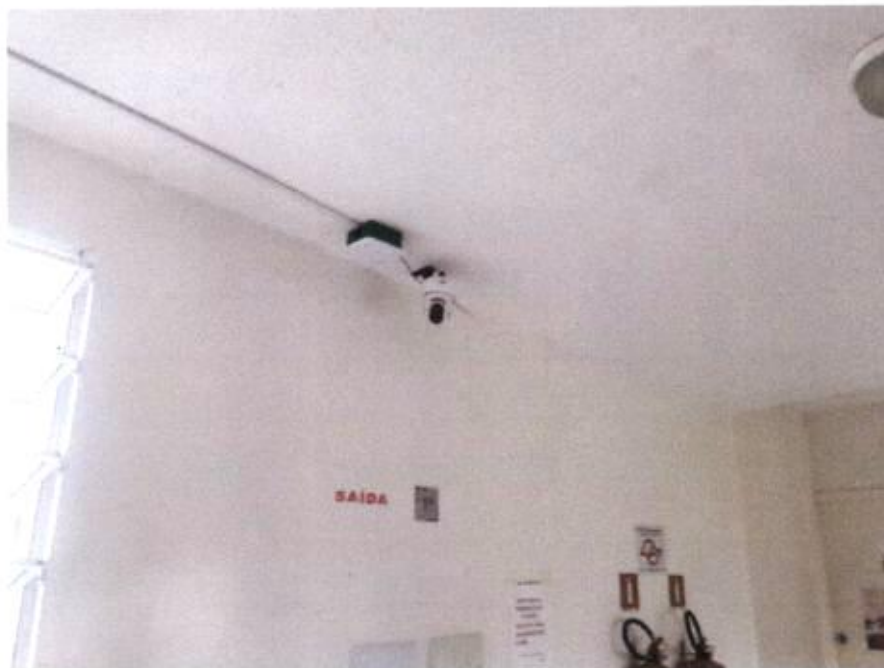
10- Sistema de monitoramento e segurança
