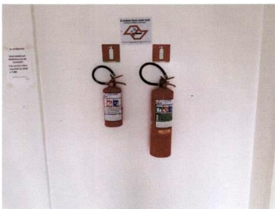
9- Sistema de combate a incêndio
