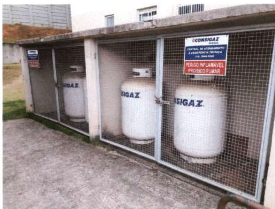
11- Bateria de GLP
