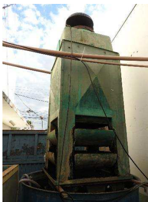
TORRE DE RESFRIAMENTO
