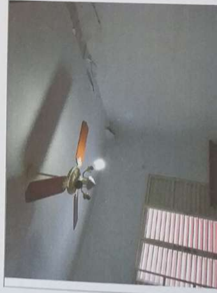
FOTO 05 – Tomada fotográfica obtida do dormitório, ilustrando descascamento da pintura devido a infiltrações na cobertura.
