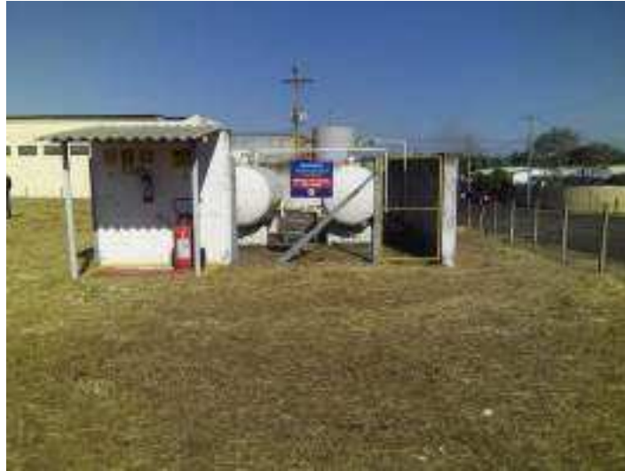
115. CENTRAL GLP (COMODATO)
