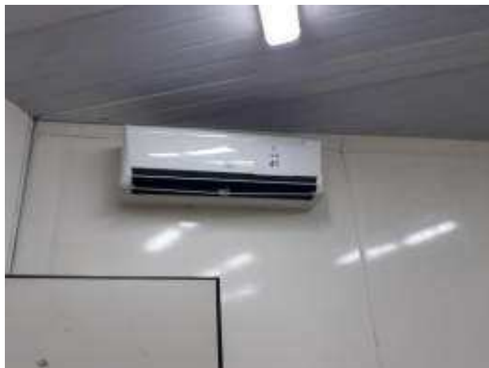
105. SPLIT AR CONDIONADO 12.000 BTU
