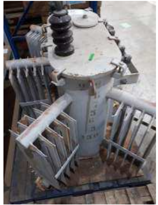
34. DOIS TRANSFORMADORES 150 KVA
