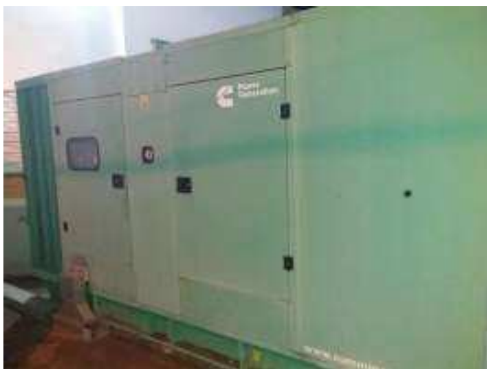
160. GERADOR 375 KVA MOTOR CUMMINS
