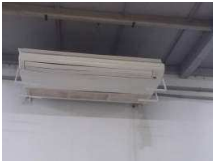
106. DOIS AR CONDICIONADO PISO-TETO
