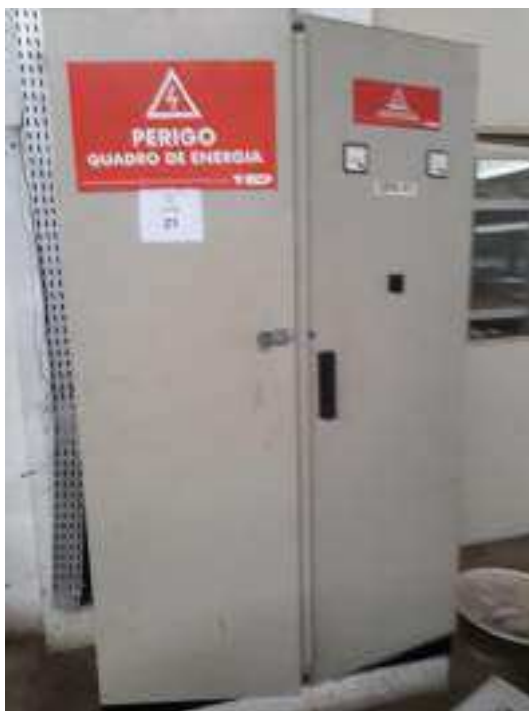
25. QUADRO DE ENERGIA
