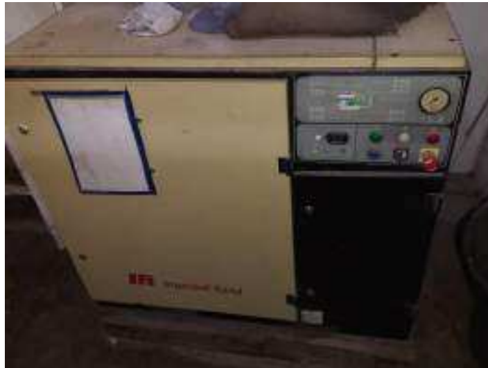
10. COMPRESSOR DE AR INGERSOL RANGE
