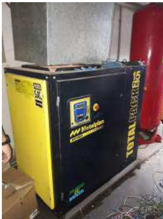
03- COMPRESSOR METALPLAN 15 HP
