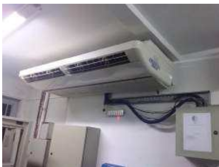
104. DOIS SPLIT AR CONDICIONADO 30.000 BTU
