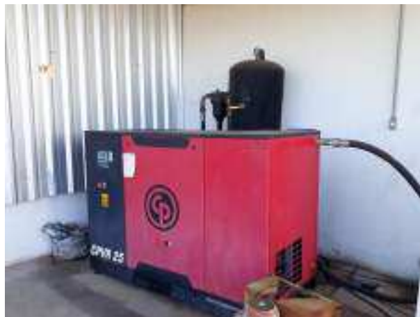
08. COMPRESSOR DE AR CHICAGO PNEUMATIC PARAFUSO CVPR 25 C TQ PULMÃO
