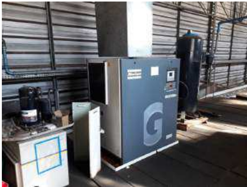
01 . COMPRESSOR ATLAS COPCO GA VSDFF E TANQUE PULMÃO
