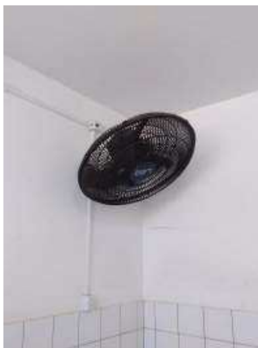
86. VENTILADOR DE PAREDE
