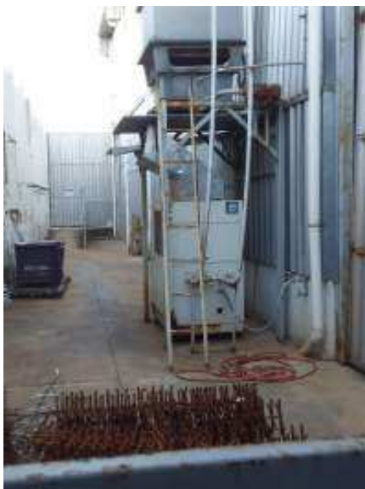
111. REFRIGERADOR PARA PROCESSO INDUSTRIAL
