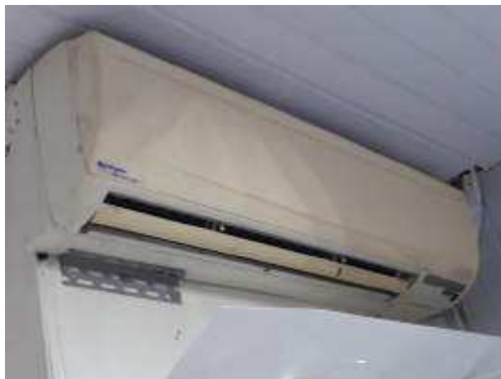
103. CINCO SPLIT AR CONDICIONADO 18.000 BTU
