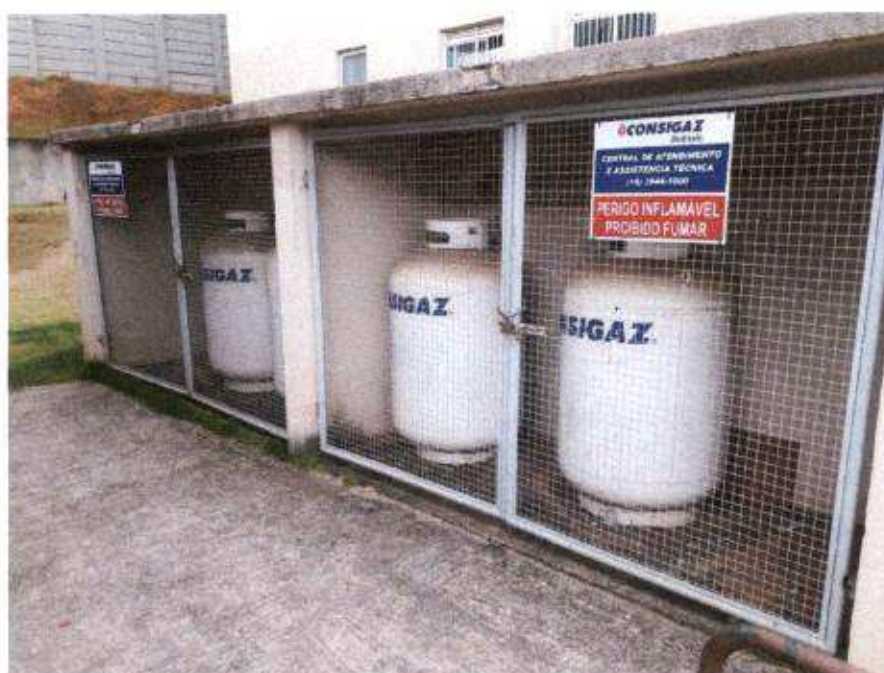
11- Bateria de GLP
