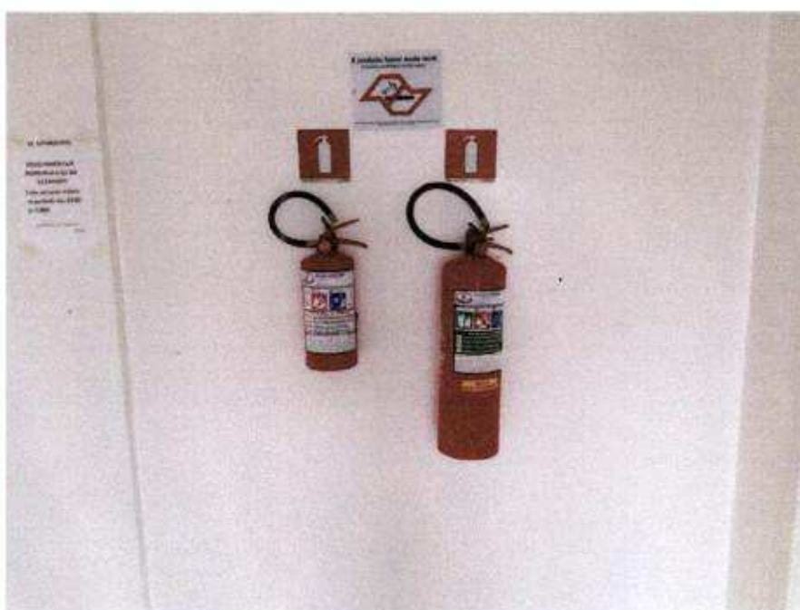
9- Sistema de combate a incêndio
