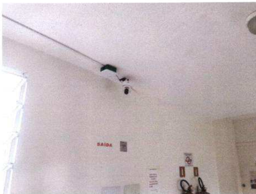
10- Sistema de monitoramento e segurança
