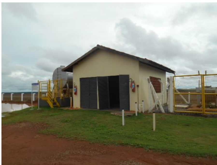
FOTO Nº 09: Vista da Casa do Gerador.
