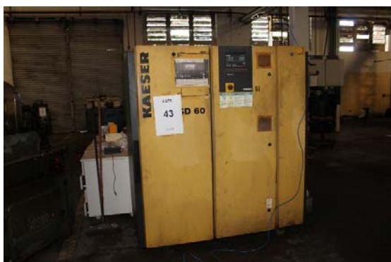
Lote 043 - COMPRESSOR KAESER BSD 60-1
