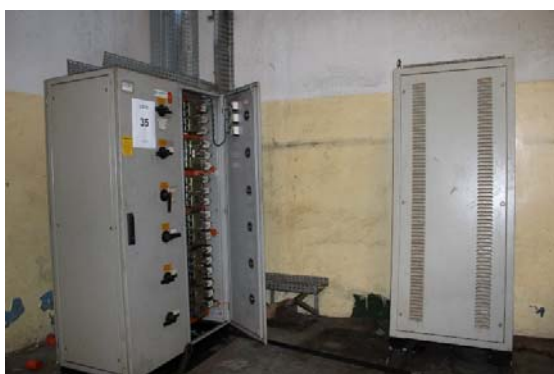
Lote 035 - Painel de Comando e Cabine Secundária
