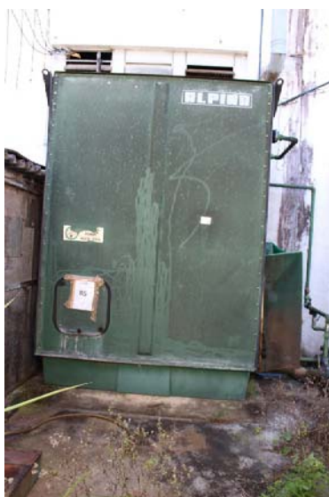
Lote 085 - TORRE DE RESFRIAMENTO-1
