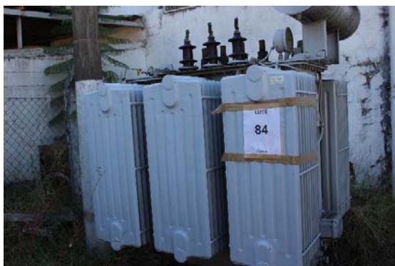
Lote 084 - Transformador Itaipu 1000 KVA-1
