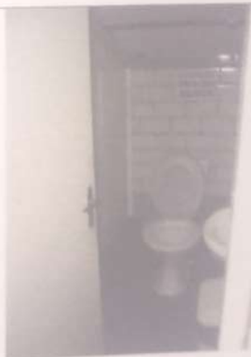
Foto 24 – Banheiro na garagem do subsolo.
